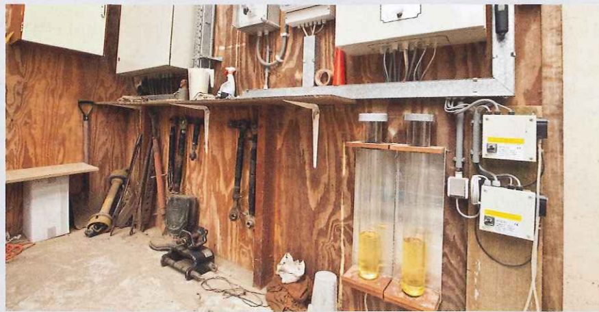
Tegenwoordig hebben veel telers de toepassing van Talent geautomatiseerd en gekoppeld aan de bewaarcomputer. In de glazen cilinders zit het middel.
