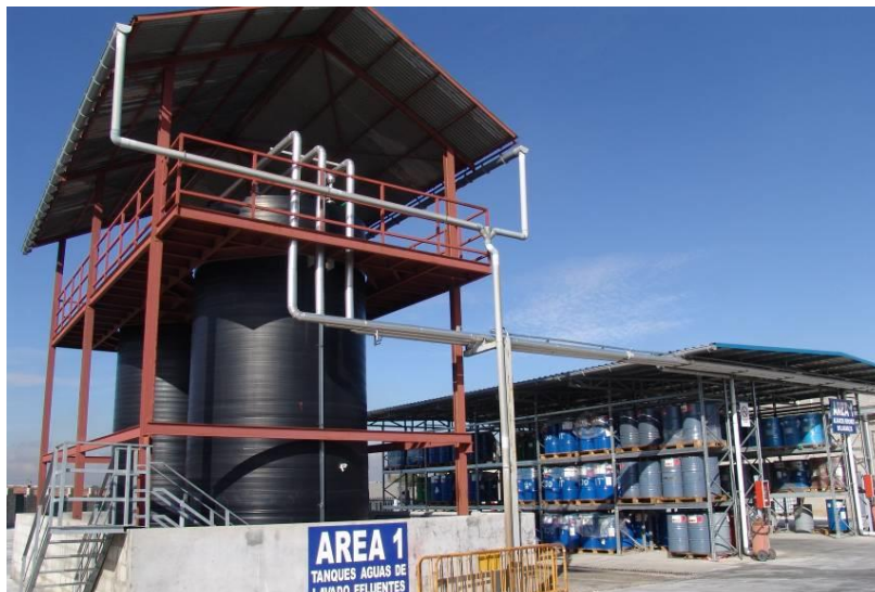
Imagen 15 Tanques de efluentes
