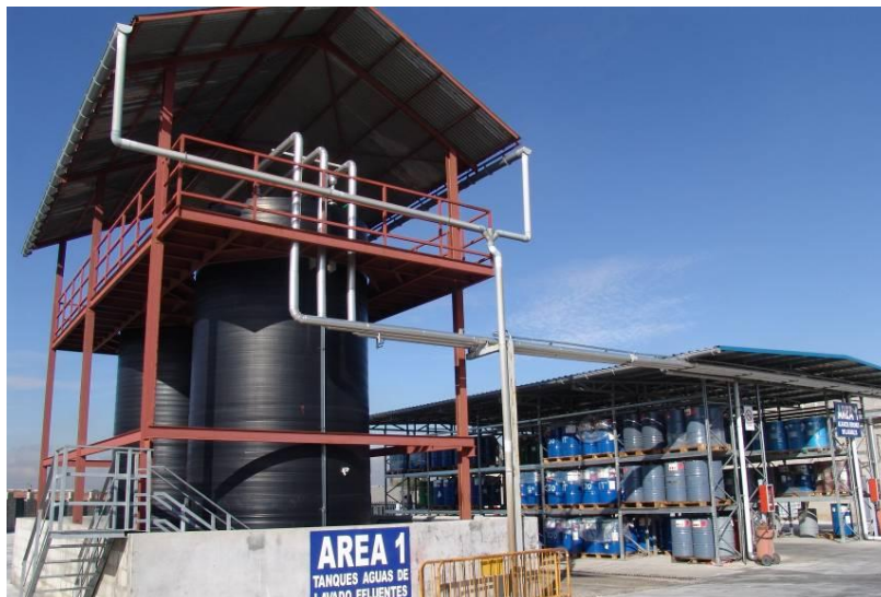
Imagen 7 Tanques de efluentes
